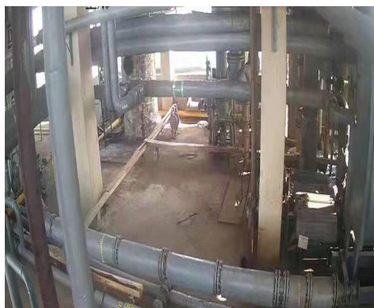
图 3.3-8 氯乙烷车间(内)
